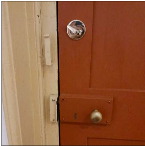
68-1: Modern door hardware.
